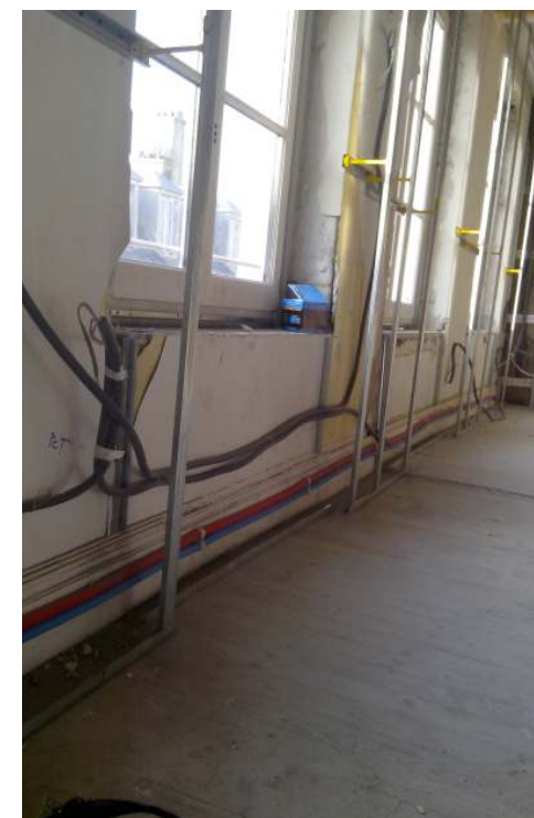
Réseaux hydraulique dans les doublages
